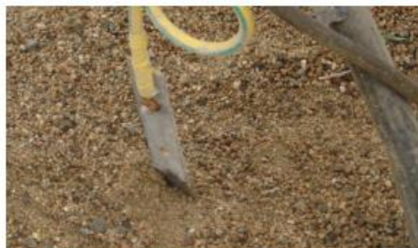
图 8-9 接地体与配电箱的标准连接参照图（接地体扁铁通过黄绿双色线与 PE 排连接）
