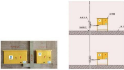
楼层配电箱、电缆敷设
