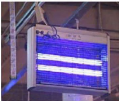
食堂配备灭蝇灯
